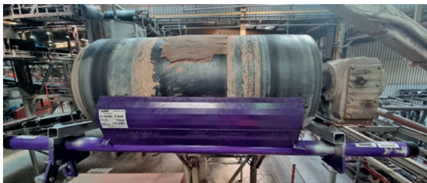
Skrobak czołowy jednosegmentowy zamontowany na bębnie zrzutowym przez serwis Beltor
