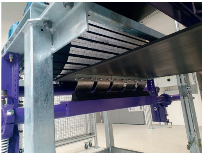
Skrobak z elementami segmentowymi z węglików spiekanych zamontowany za bębniem zrzutowym
